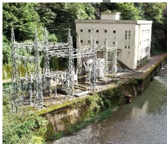
上寺津発電所 最大出力 16,400kW(当社最大)
